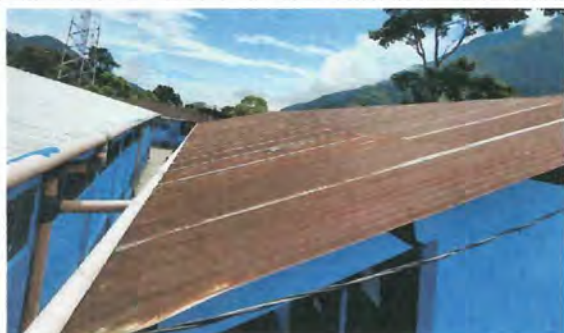
Foto 3: Sustitución de lámina por deterioro por paso del tiempo, imagen parcial de donde se localizan tres salones de clases y un corredor, modulo lado Sur.
